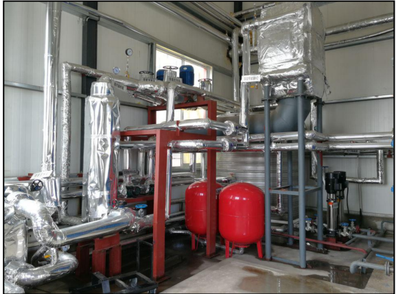
锅炉水泵减震基座
